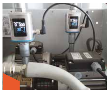
4 Jusqu'à 4 pompes à adjuvants + les débitmètres
