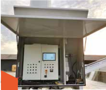
4 Armoire de contrôle pour la gestion de la machine
