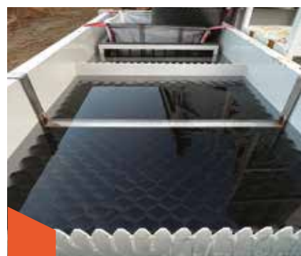
3 Bac de décantation pour le recyclage et la réintégration des eaux dans le malaxeur
